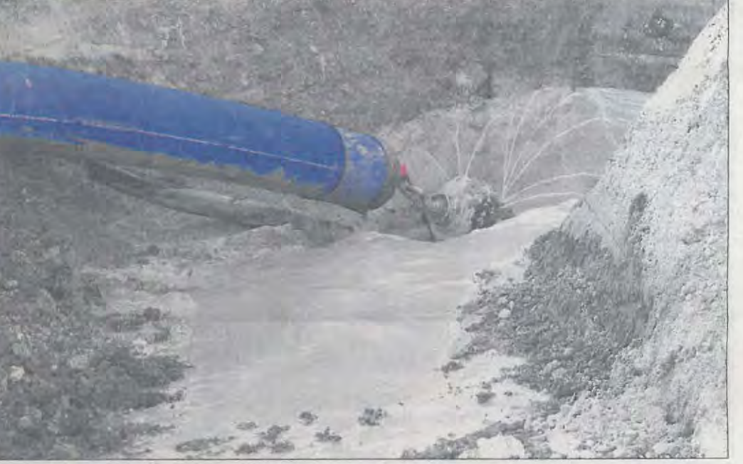
Auch das ist die Arbeit der Achengruppe: Bei der Verlegung einer 355 Millimeter großen Trinkwasserleitung in Tengling findet das sogenannte Spülbohrverfahren Anwendung.
